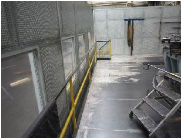
Abbildung 6 – Großzerspanungsmaschine mit Zugangsabsicherung, mit Lärmmindeereigenschaften und Absturzsicherung am Maschinentisch
