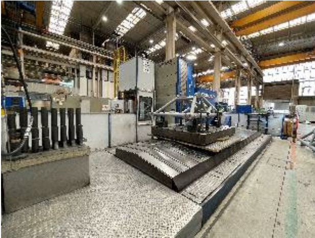
Abbildung 4 – Großzerspanungsmaschine mit Zugangssicherung, bestehend aus feststehenden trennenden und nicht trennenden Schutzeinrichtungen
