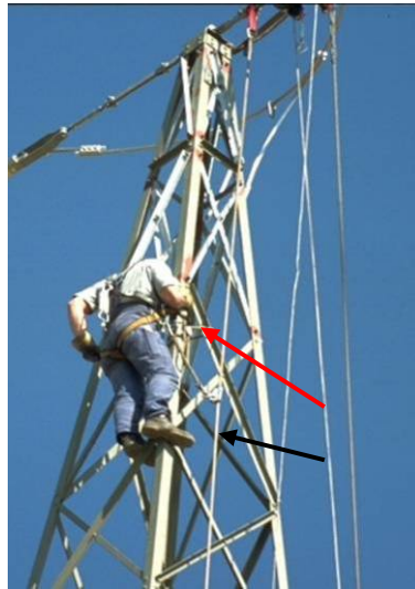
Abbildung 2: Feste Positionierung der Person durch Verbindungsmittel (Halteseil) am Mast (BGIA)
