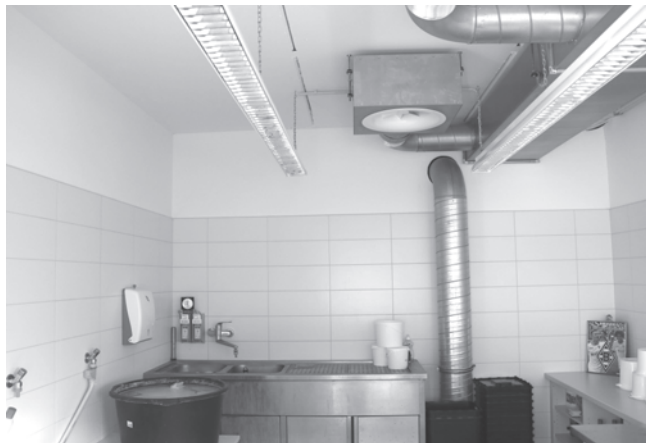
Bild 2. Spülküche zum Asservatenentsorgen; Lochblechabsaugung und Zuluft im Deckenbereich. Quelle: Autoren
