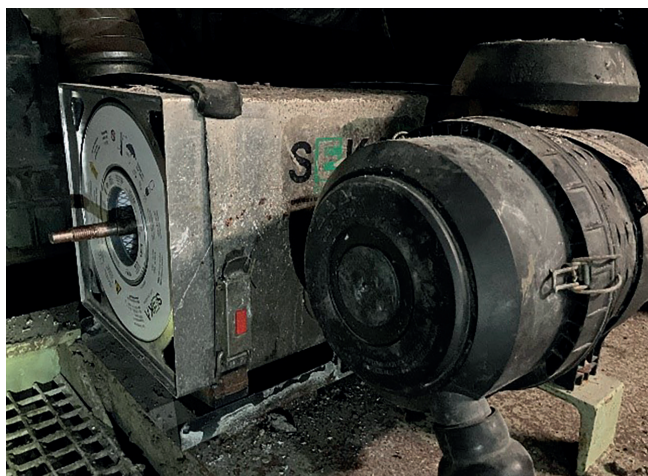
Bild 10. Filteraustausch optimierter Schutzbelüftung (ohne Deckel). Grafik: Fa. K+S
