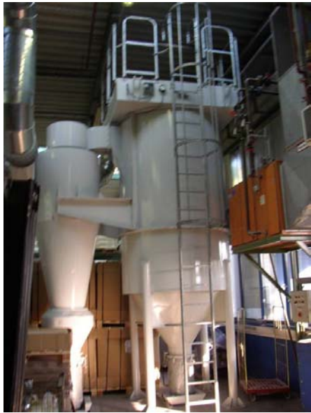
Abbildung 4: Abluftanlage mit einer Nennleistung von 10 000 m 3 /h
