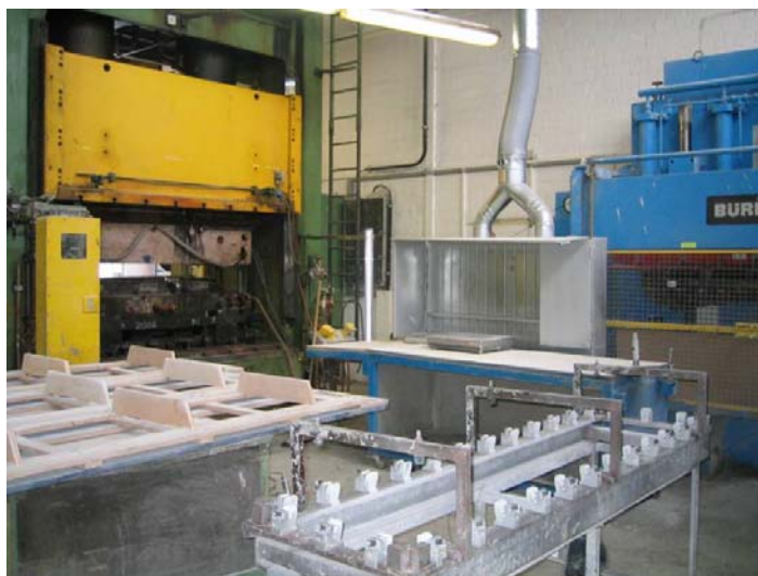
Abbildung 12: Absaugwand hinter einem Zuschneidetisch
