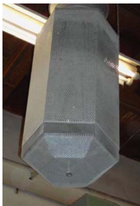
Abbildung 11: Zuluftdrallauslässe im Deckenbereich
