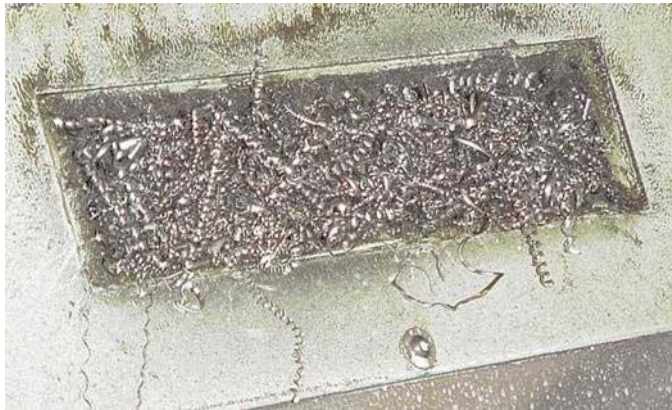
Abbildung 4: Beispiel für eine durch Späne zugesetzte Erfassungseinrichtung
